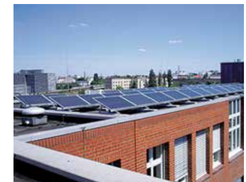
Abbildung 12 Aufgeständerte Photovoltaikanlage der Moses-Mendelssohn-Oberschule Berlin
