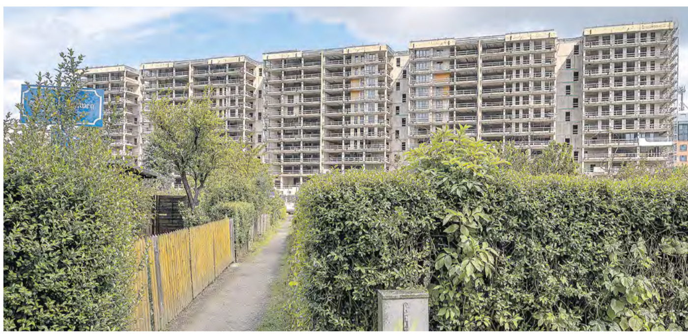
Stahlbetonskelett an der Prager Straße: Die Stadt muss abreißen und neu bauen, ein Umbau kommt nicht infrage. Foto: Stadt Leipzig/R. Quester
