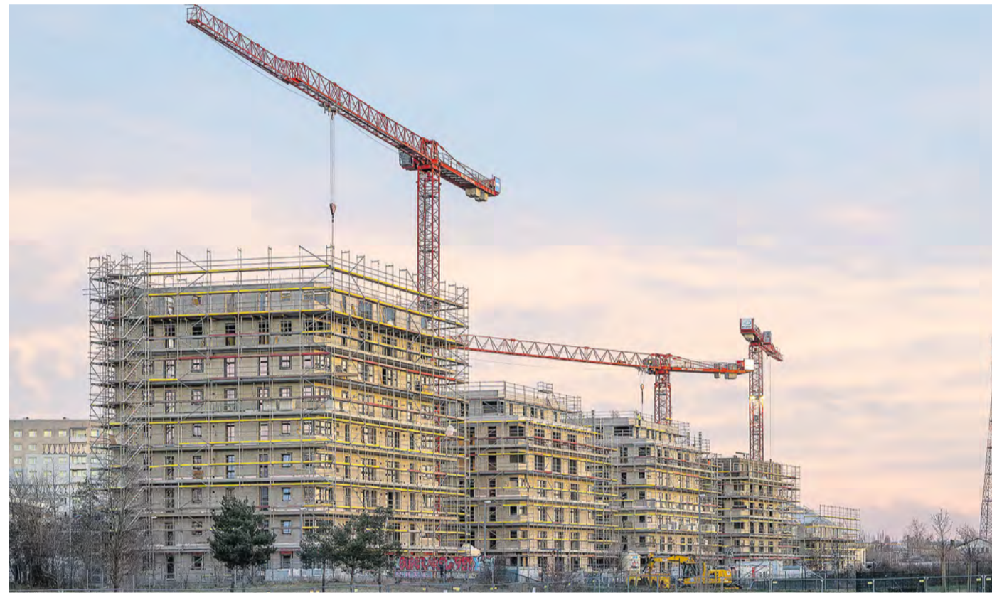
Für das Wohnviertel Bayerischer Bahnhof drehen sich am Dösner Weg die Kräne auch für soziales Wohnen: Hier entstehen aktuell 222 Wohnungen für Singles als auch für junge Familien mit ein bis vier Zimmern. Zehn Prozent dieser Wohnungen werden an Leipzigerinnen und Leipziger mit weißem Wohnberechtigungsschein vermietet. Foto: Stadt Leipzig/Roland Qvester
