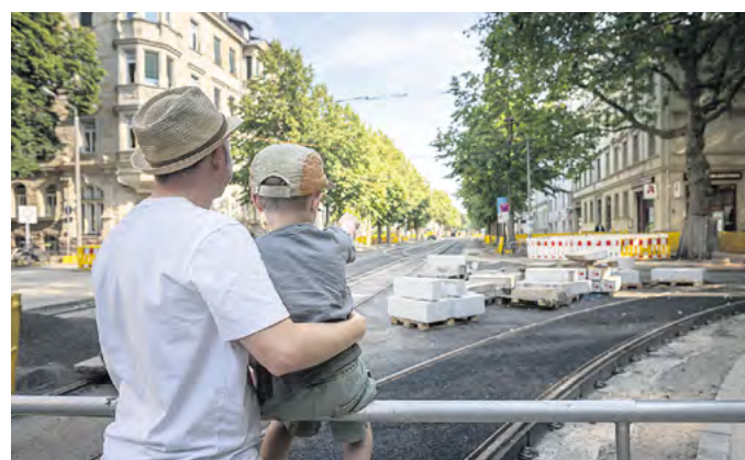
Ein Bild aus dem Bautagebuch: Es illustriert, wie groß und komplex die Bauarbeiten für die Sanierung der gesamten Waldstraße zwischen Waldplatz und Primavesistraße gewesen sind. Foto: Eric Kemnitz
