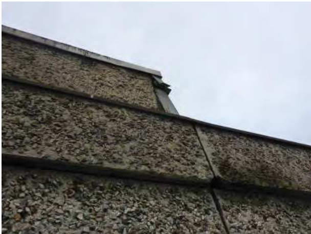
Halle 16: pot. Sommer-/Zwischenquartier-eigenschaften unter Verblechungen und in Fugen
