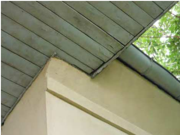
Halle 21, Spalte in Vordachmitn pot. Fledermausquartiereigenschaften
