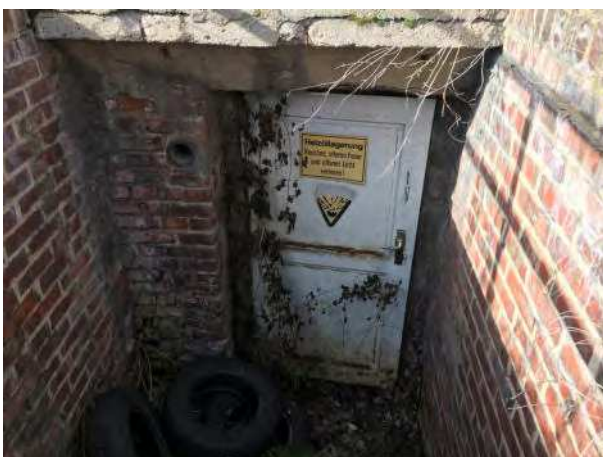
Halle 21: Kellereingang nicht vollständig verschlossen
