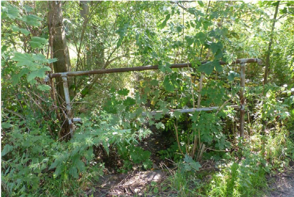
Foto 5: ausgetrockneter Graben im südlichen Baufeld
