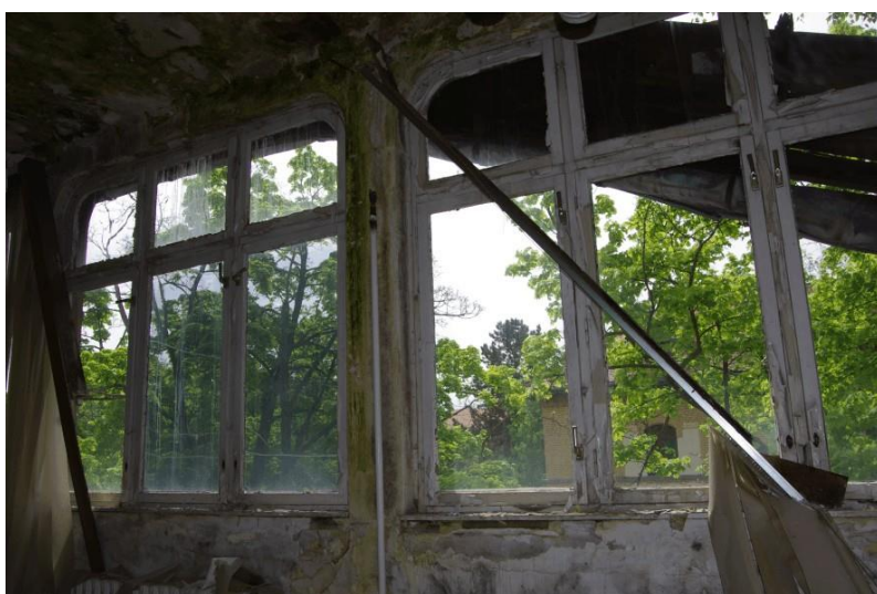
Detail östliche Veranda mit schweren Nässeschäden
