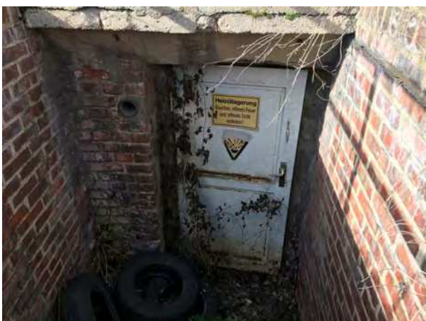
Halle 21: Kellereingang nicht vollständig verschlossen
