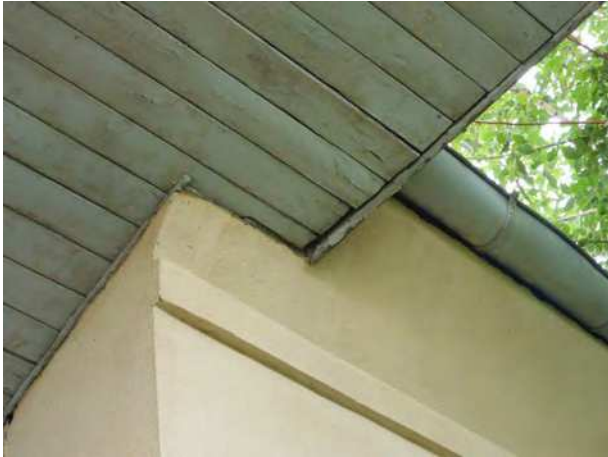
Halle 21, Spalte in Vordachmitn pot. Fledermausquartiereigenschaften
