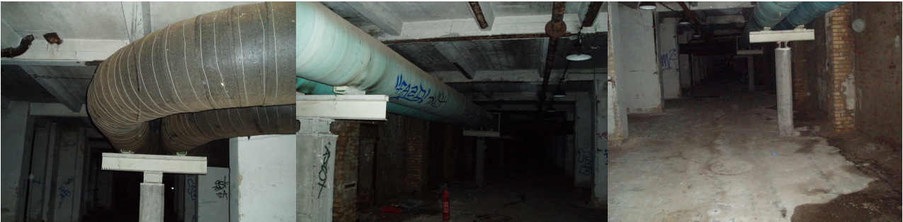
Bild 9: Unterirdische Fernwärmeleitungen unter dem Wilhelm-Leuschner-Platz Quelle: Begehungsdokumentation Netz Leipzig
