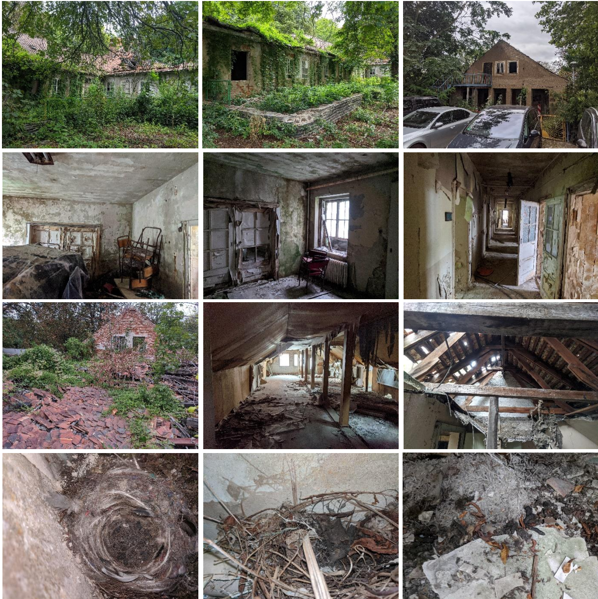
Abbildung 6: Außen- und Innenansichten des Kindergartengebäudes, mit deutlichen Anzeichen für Verfall und Feuchtigkeit.
