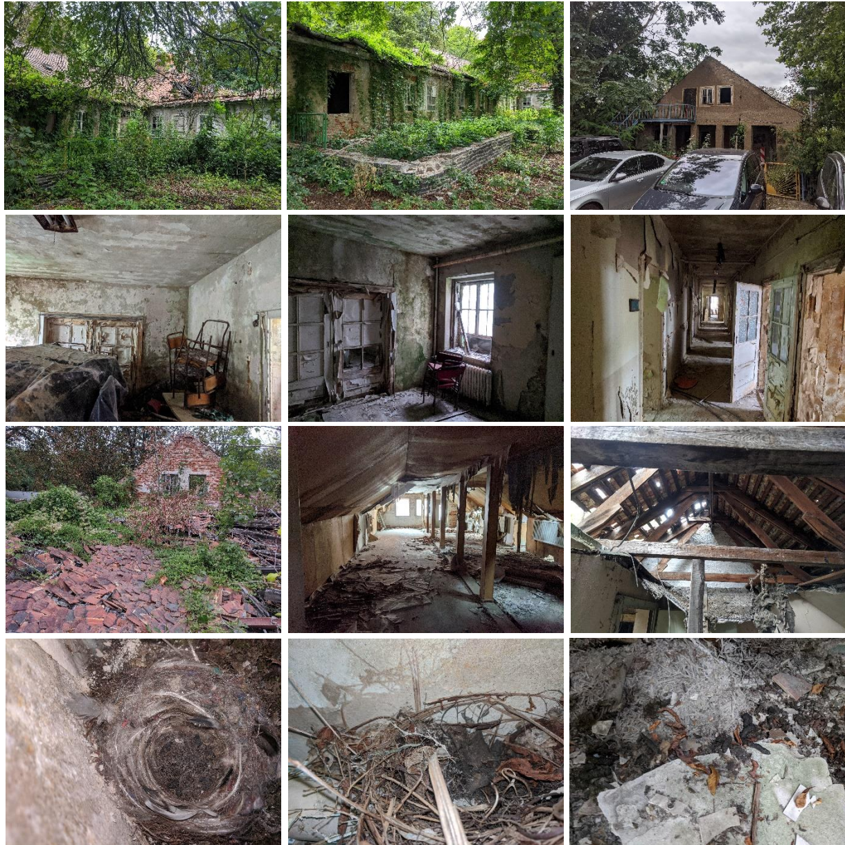
Abbildung 2: Außen- und Innenansichten des Kindergartengebäudes, mit deutlichen Anzeichen für Verfall und Feuchtigkeit.
