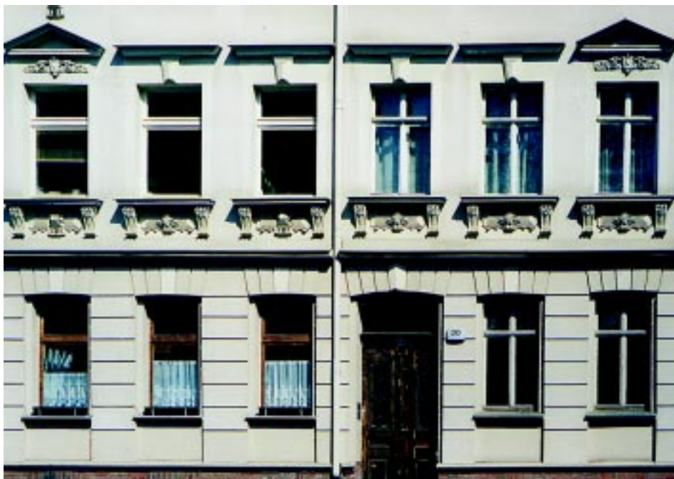
Aufwendig sanierte Fassade, bei der das Gesamterscheinungsbild jedoch durch den teilweisen Einsatz von isolierverglasten Plastefenstern nachhaltig gestört ist
